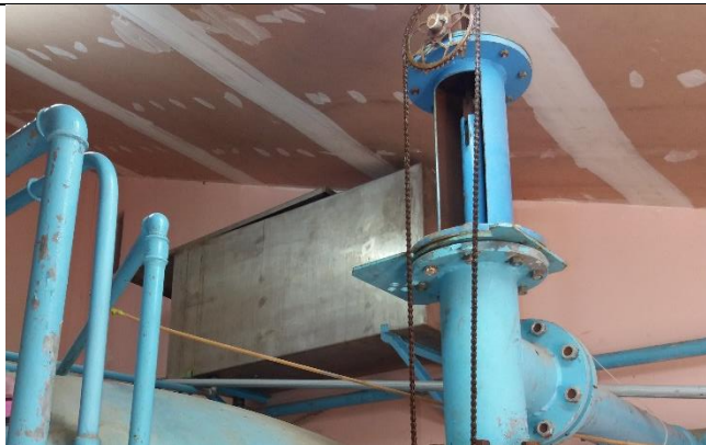
Figure 9 : bac de disconnexion de l'eau de ville
