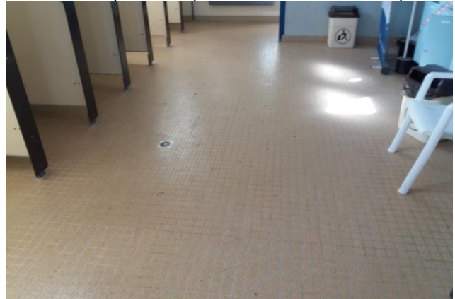
Absence de pentes ou pointes de diamants vers siphons
