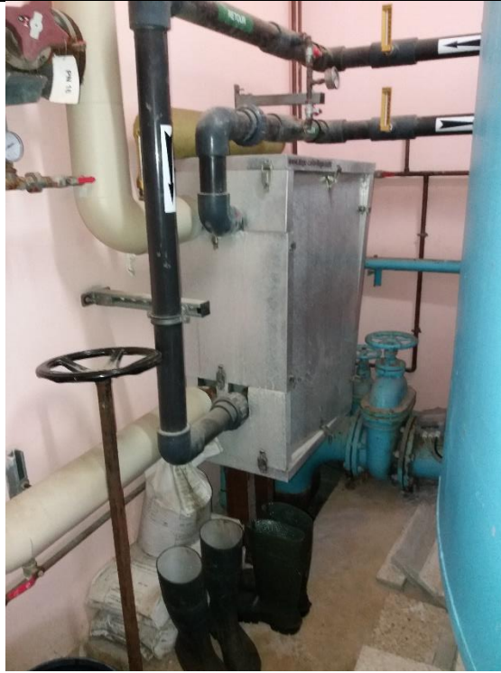
Figure 22 : échangeur de chaleur
