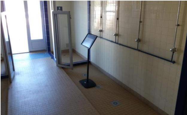
Décaissé de 10cm au droit des douches – Non PMR
