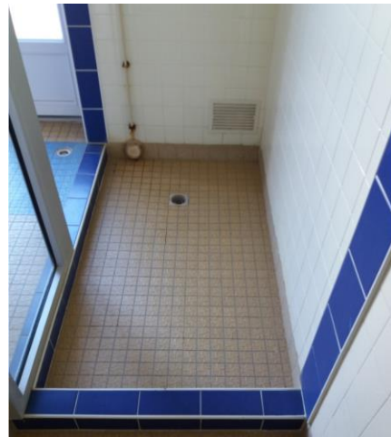
Pédiluve 2 intérieur en sortie de douche
