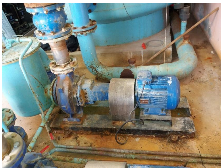
Figure 4 : pompe de filtration
