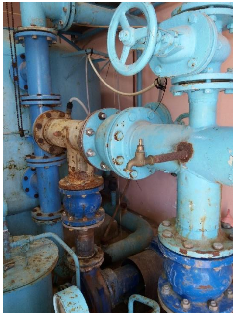
Figure 6 : réseaux de refoulement avec vannes et prise d'échantillon
