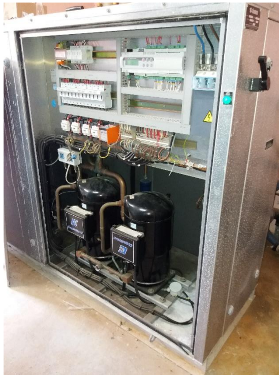
Figure 21 : Pompe à chaleur
