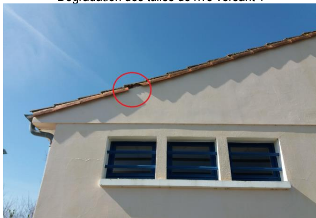
Dégradation des tuiles de rive versant 1
