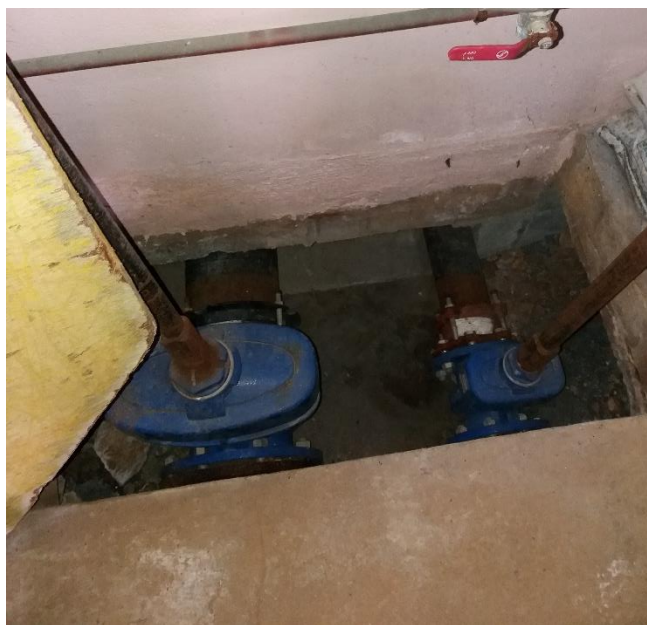
Figure 10 : refoulement et vannes de réglage des deux bassins
