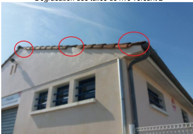
Dégradation des tuiles de rive versant 2
