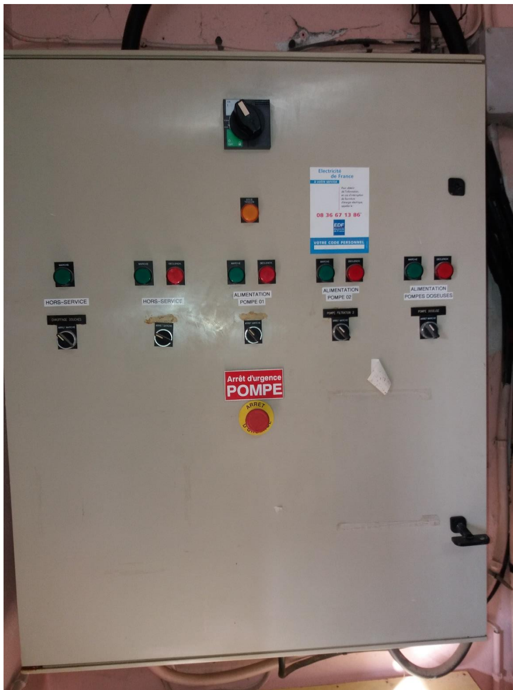
Figure 26 : armoire du traitement d'eau
