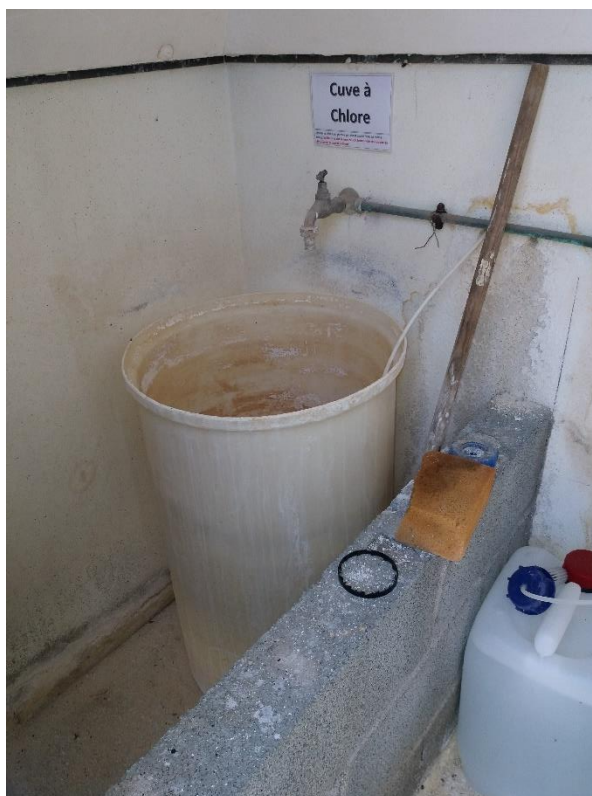
Figure 13 : cuve à chlore
