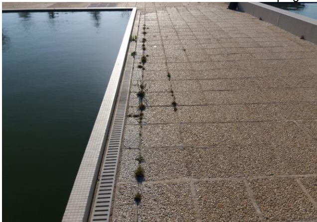
Absence de dissociation des eaux de bassin des plages
