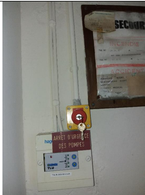
Figure 31 : arrêt d'urgence pompes filtration
