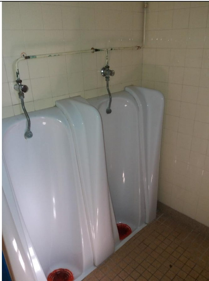
Figure 18 : urinoirs avec la distribution d'eau froide
