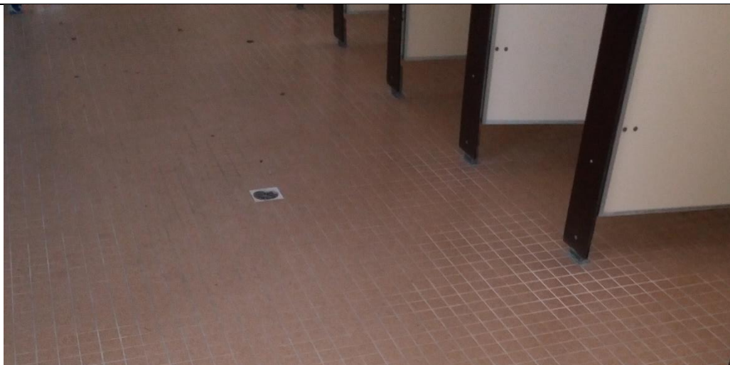
Figure 20 : siphon des vestiaires
