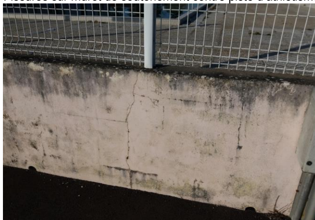
Fissures sur muret de soutènement contre piste d'athlétisme
