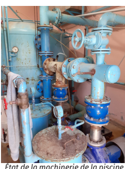
Etat de la machinerie de la piscine
